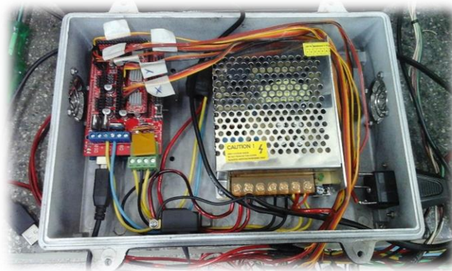
Figura 3.14: Caixa com sistema eletroeletrônico.
