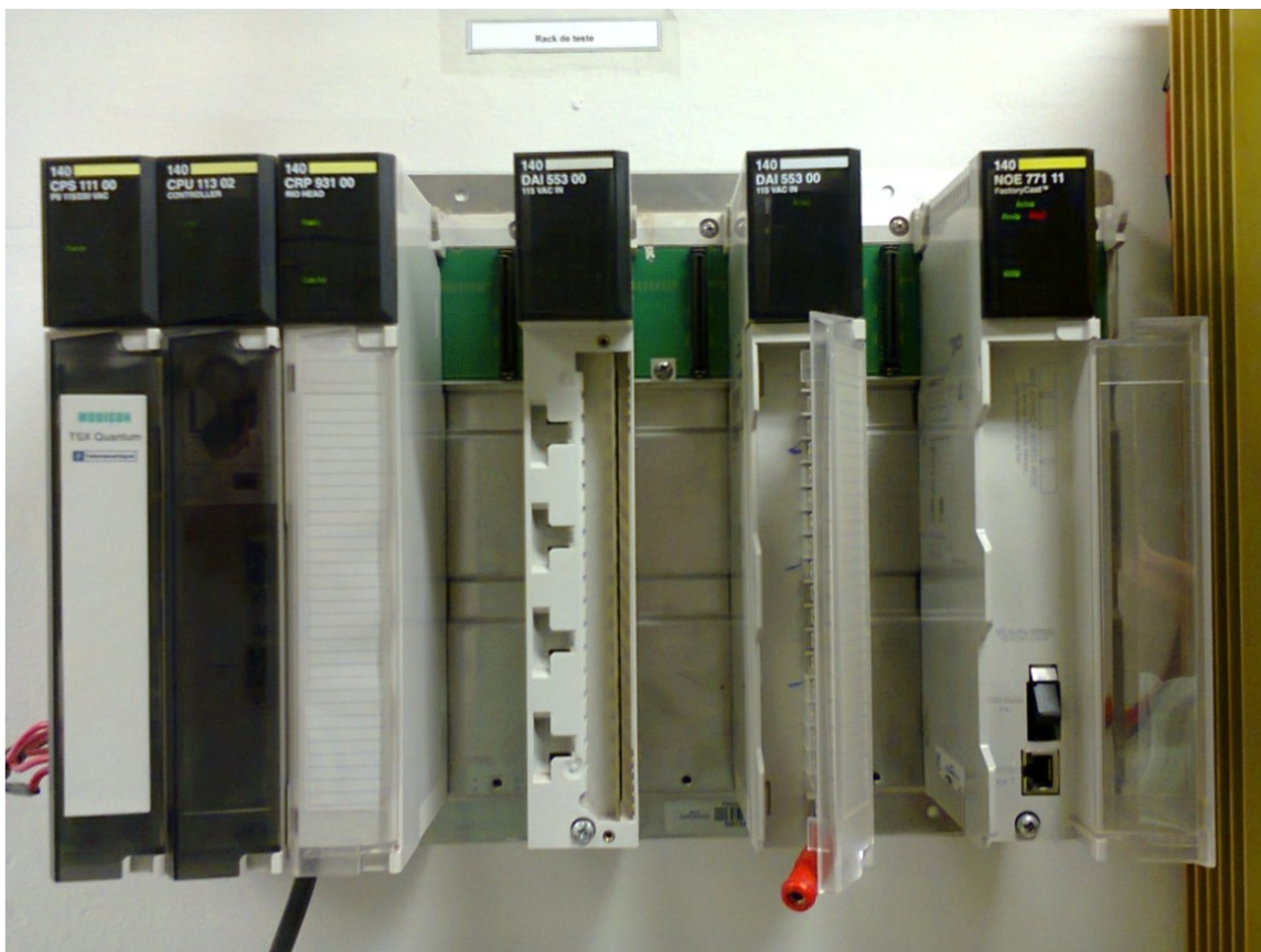
Figura 8 – Rack de testes com PLC da linha Quantum.
