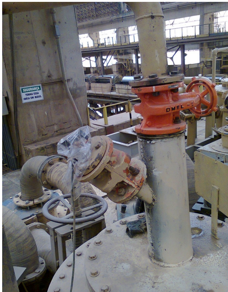
Figura 13 - Transmissor de pressão instalado no distribuidor da bateria TA-1413116.
