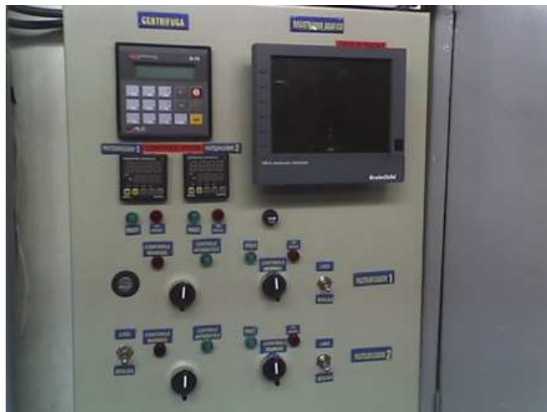
FIGURA 22 – Estação de IHM
