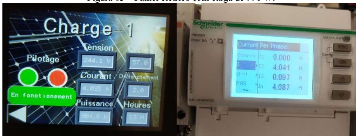
Figura 63 – Painel elétrico com carga de 990 W.
