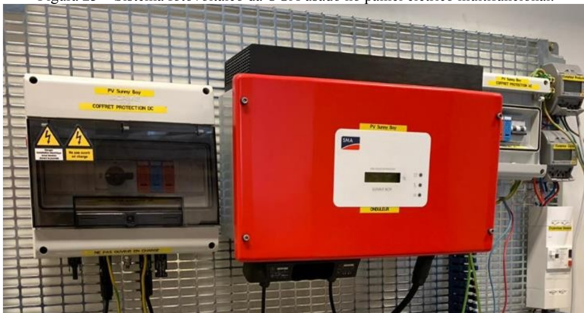
Figura 23 – Sistema fotovoltaico da UGA usado no painel elétrico multifuncional.
