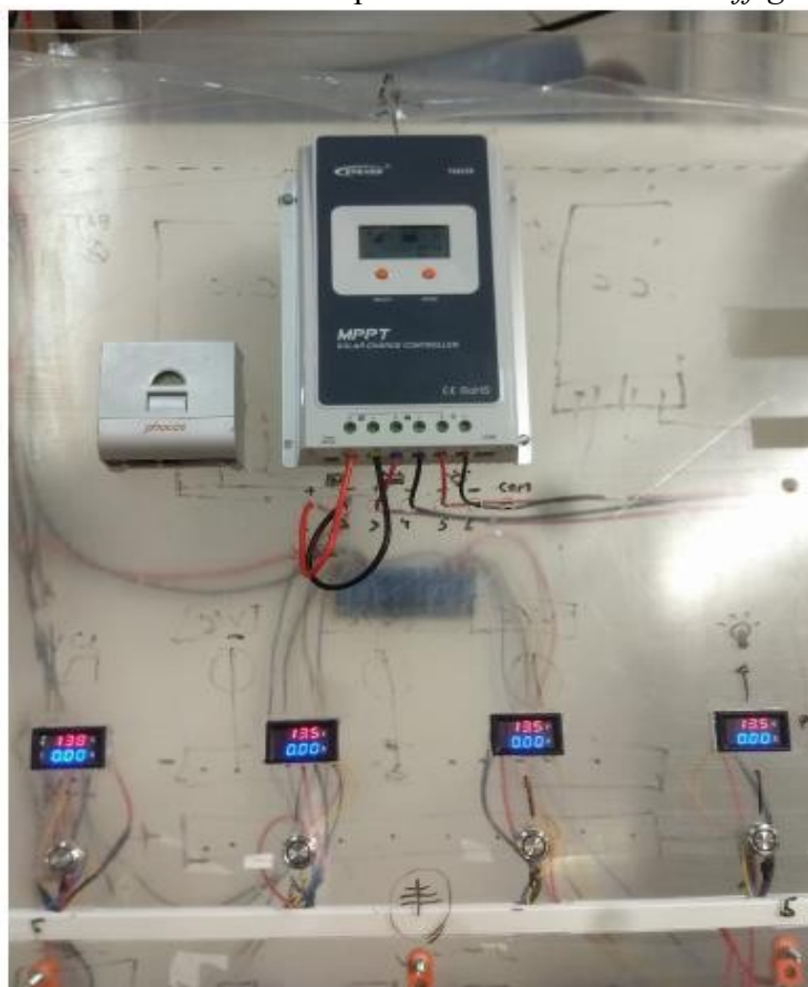
Figura 8 – Bancada didática para sistema fotovoltaico off-grid .
