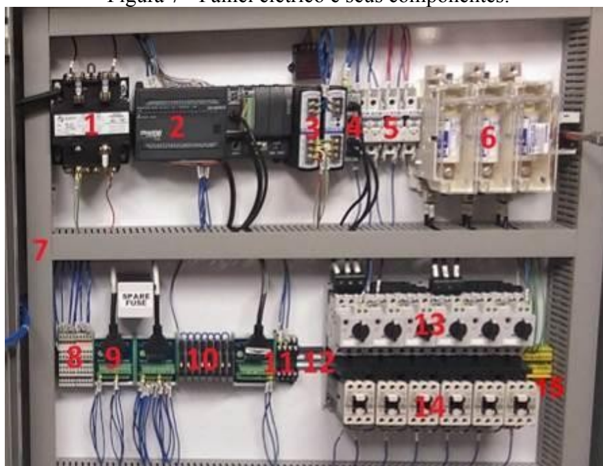
Figura 7 - Painel elétrico e seus componentes.
