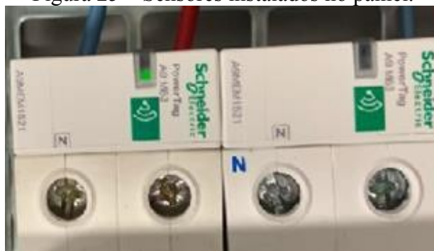
Figura 25 – Sensores instalados no painel.
