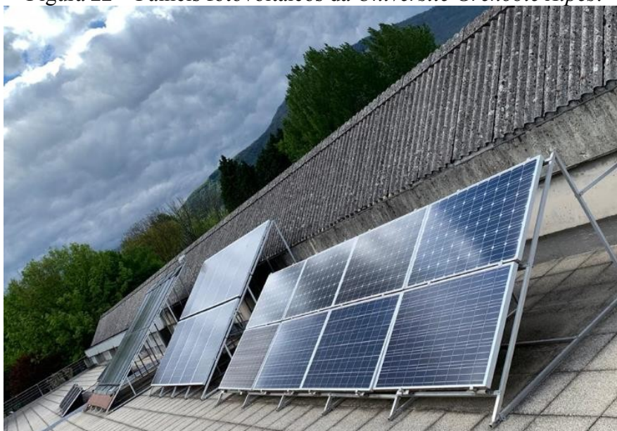
Figura 22 – Painéis fotovoltaicos da Université Grenoble Alpes .
