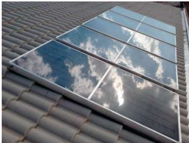
Figura 6 – Coletores de Placas Planas.
