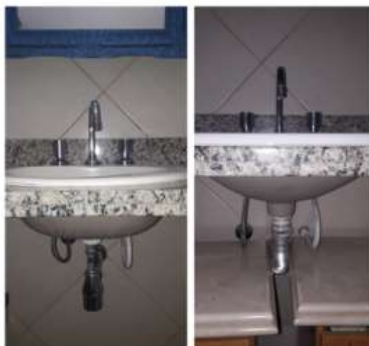
Figura 32 – Sistema de canalização dos lavatórios da Residência 2.
