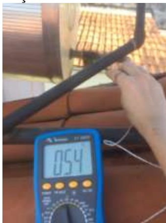
Figura 36 – Temperatura na canalização de entrada do reservatório térmico na Residência 1.
