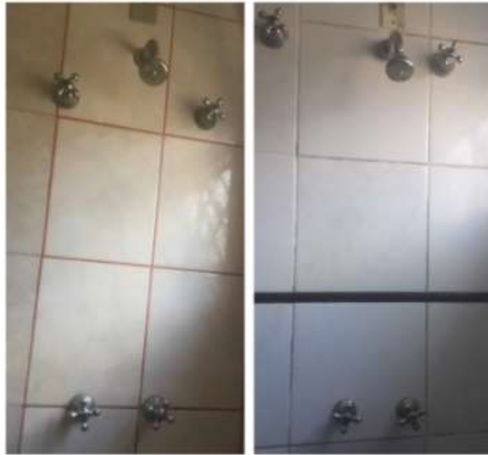
Figura 27 – Sistema de canalização dos dois chuveiros da Residência 1.
