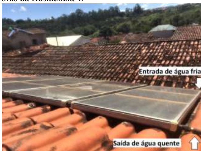
Figura 25 – Placas coletoras da Residência 1.
