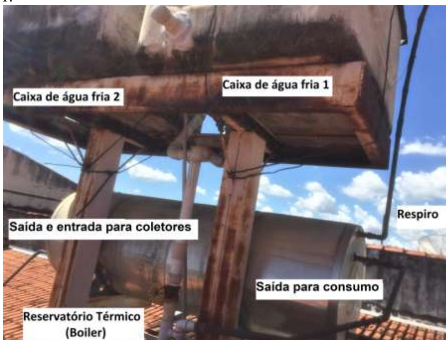
Figura 26 – Elementos do Sistema de Aquecimento Solar em Configuração Termossifão na Residência 1.
