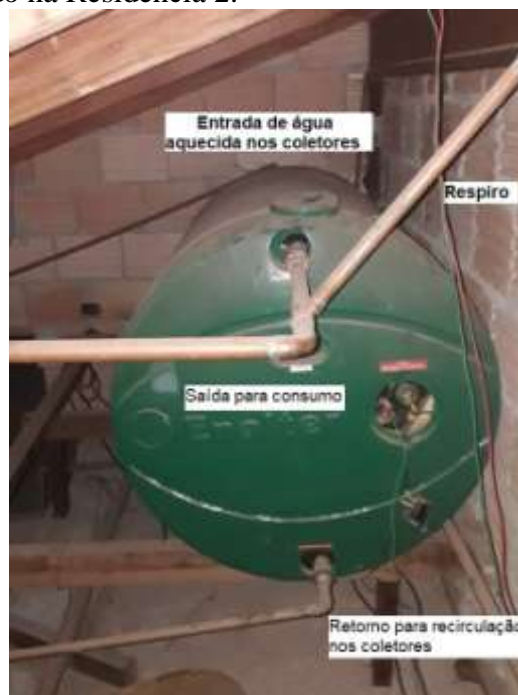
Figura 30 – Boiler utilizado na Residência 2.
