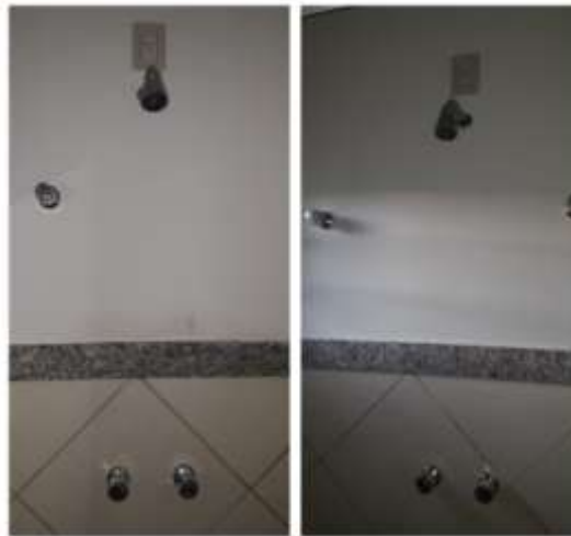
Figura 31 – Sistema de canalização dos dois chuveiros da Residência 2.
