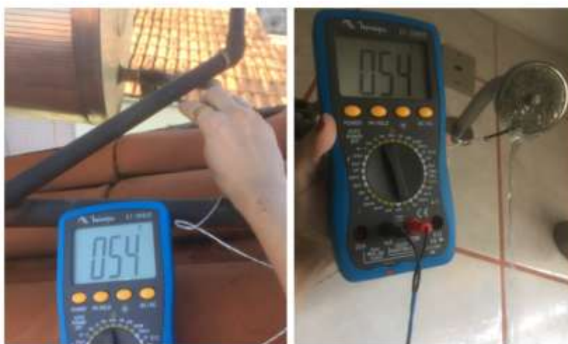
Figura 37 – Comparação da temperatura no ponto de consumo e na tubulação de entrada do reservatório térmico.
