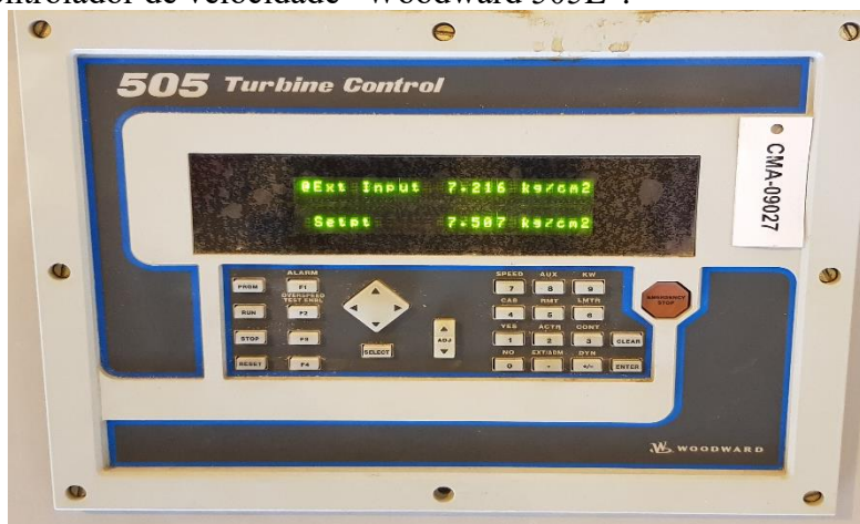
Figura 28 – Controlador de velocidade “Woodward 505E”.
