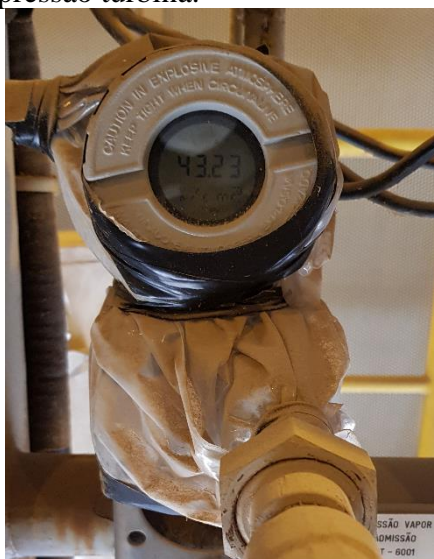
Figura 31 – Transmissor de pressão turbina.
