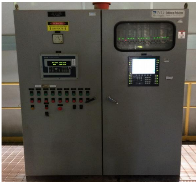
Figura 35 – Painel de controle da turbina.
