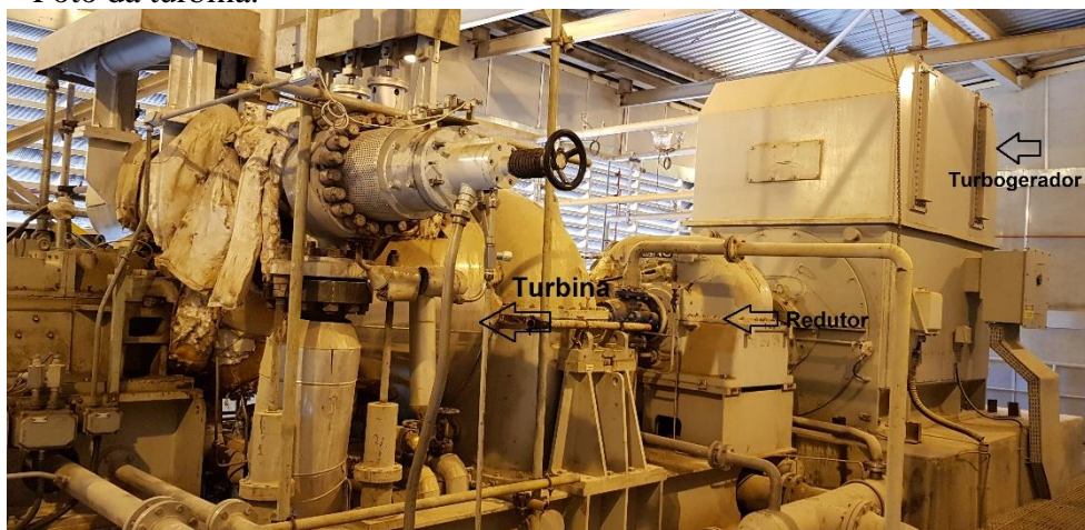
Figura 17 – Foto da turbina.
