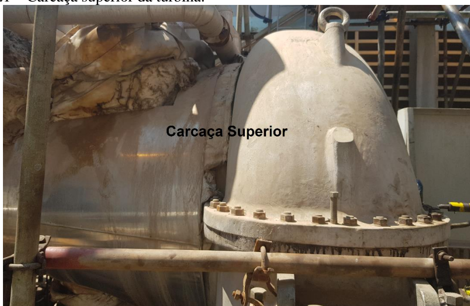
Figura 21 – Carcaça superior da turbina.
