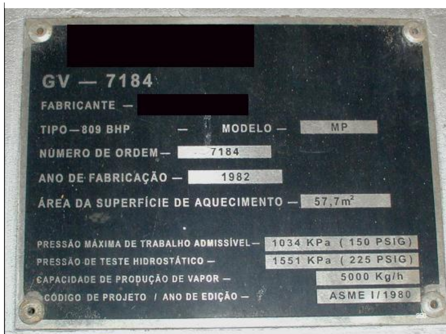
Figura 21 - Placa de identificação de caldeira
