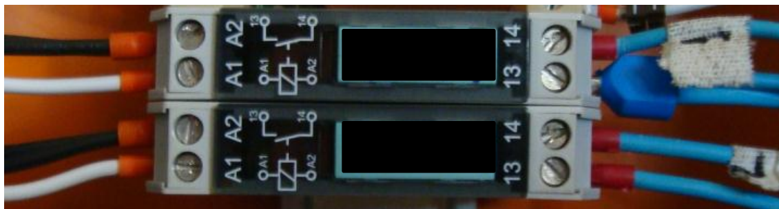
Figura 88 - Relés para acionamento do servomotor
