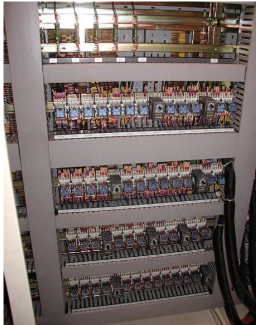
Figura 55 - Painel de acionamento - lógica a relés
