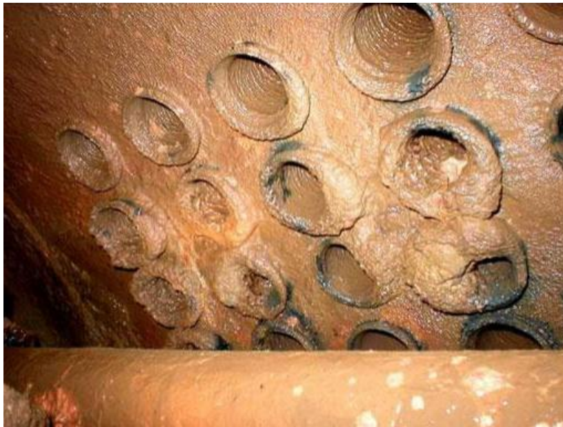
Figura 22 - Tubulão superior de uma caldeira aquatubular com elevada incrustação de lama
