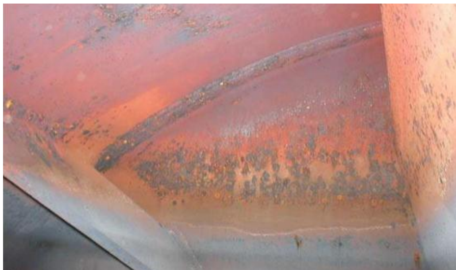
Figura 23 - Processo de corrosão localizada na carcaça de uma caldeira flamotubular
