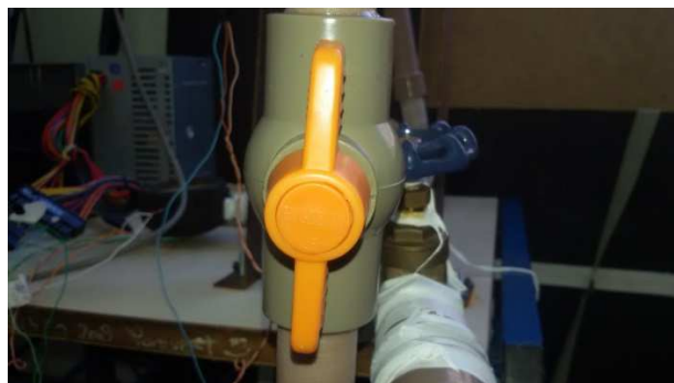
Figura 32: Válvula de esfera de controle de fluxo no recalque
