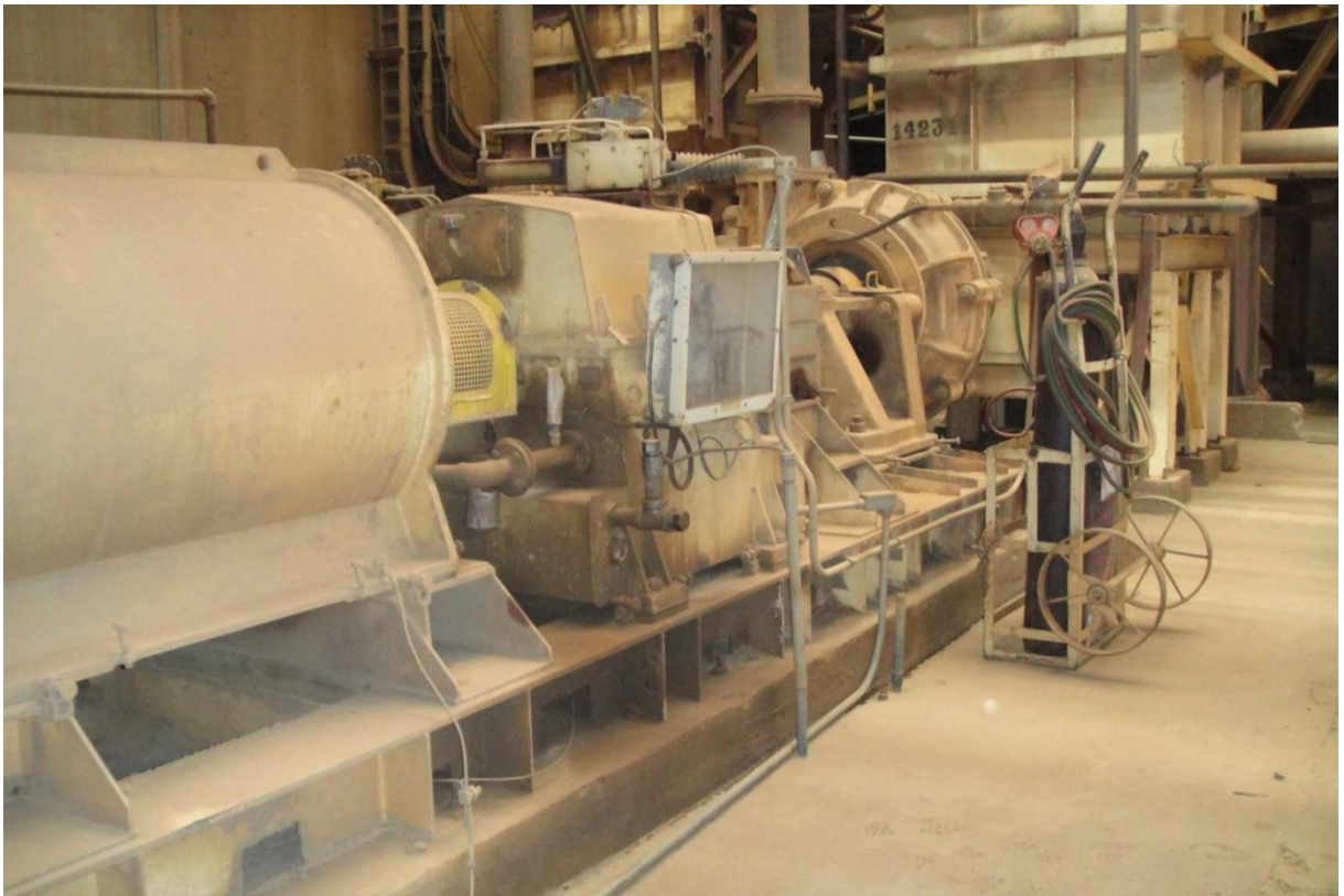
Figura 12: Motor, variador de velocidade hidráulico, redutor.
