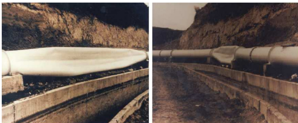
Figura 1-2 - Tubulação colapsada devido ao vácuo presente na linha
