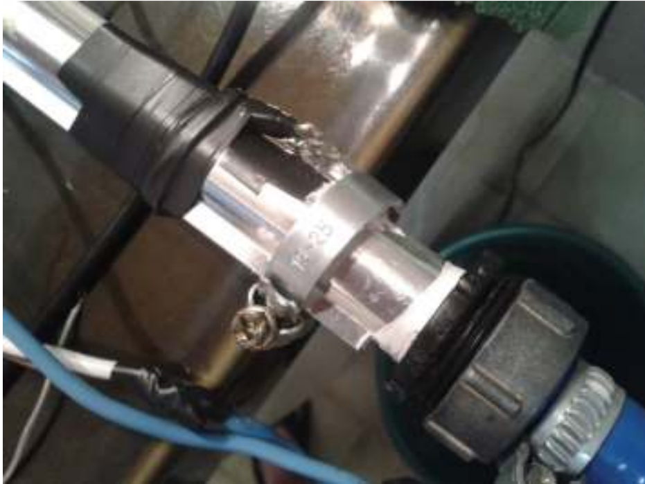
Figura 29 - Fixação do sensor da temperatura da água de entrada Fonte: do autor.
