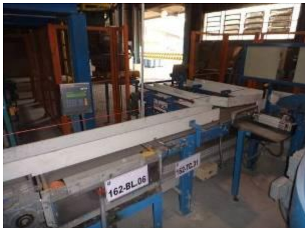
Figura 29 - Balança de checagem automática de latas
