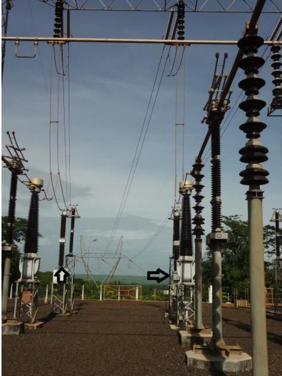
Figura 25 : Conexão do TPC a LT Jaguara_ Volta Grande 345 KV.
