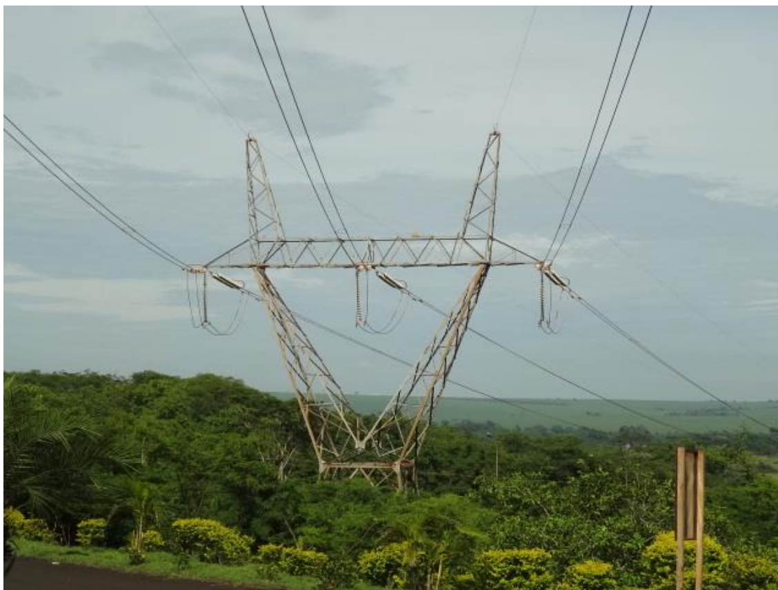
Figura 24 : LT Jaguará Volta Grande 345 KV. Subestação Volta Grande 345 KV.
