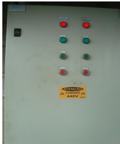
Figura 7: Painel de acionamento, vista frontal e externa
