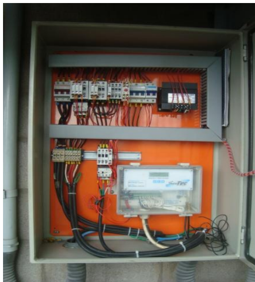
Figura 8: Painel de acionamento, vista frontal e interna
