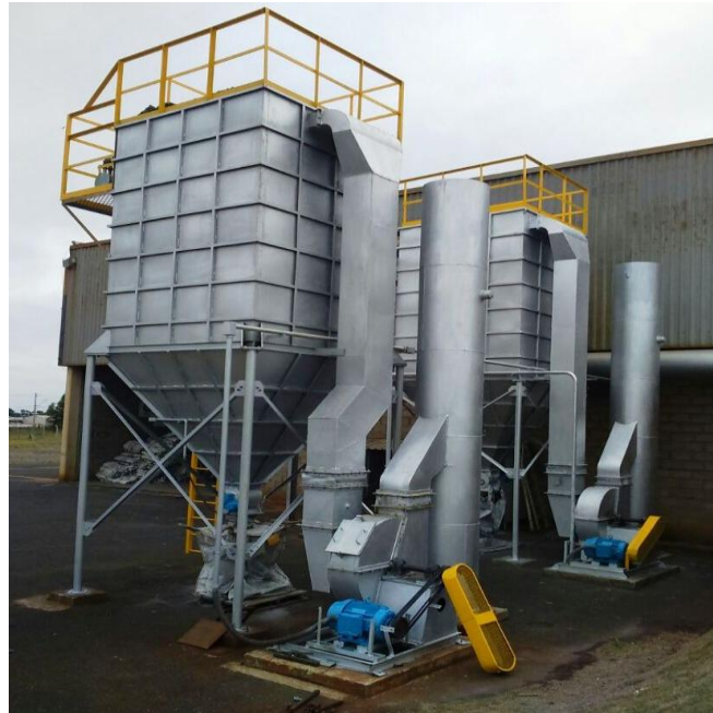
Figura 9: Filtro de mangas da FBM.
